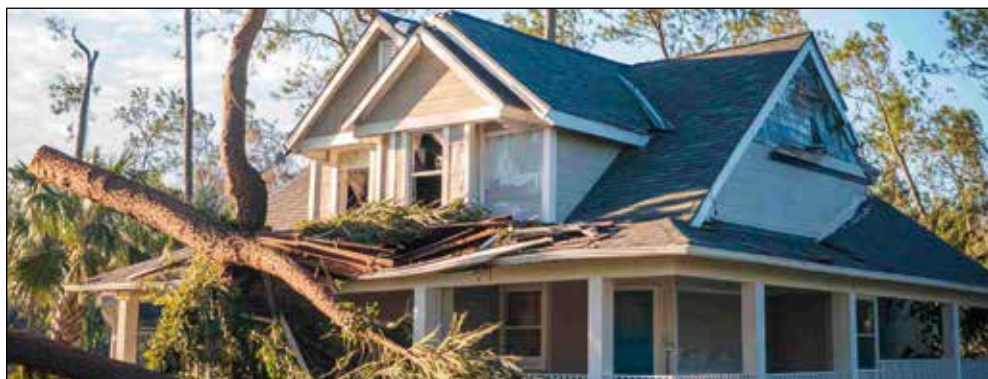
Les tempêtes peuvent endommager gravement les bâtiments.
