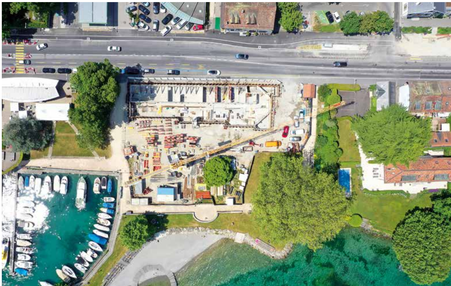
Le projet d'auberge-restaurant de Port Gitana sera thermiquement régulé par une pompe à chaleur de type eau-eau.
