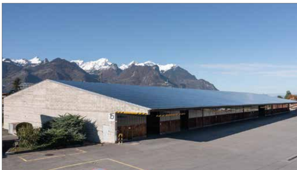
Le plus grand toit solaire transparent de Romandie sur la halle 15 de la caserne d'Aigle/VD.
