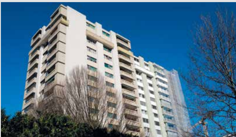
Des échafaudages couvrent une partie des façades de la tour de Vieusseux.
