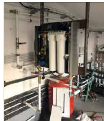
Des installations sanitaires et de chauffage complexes.
